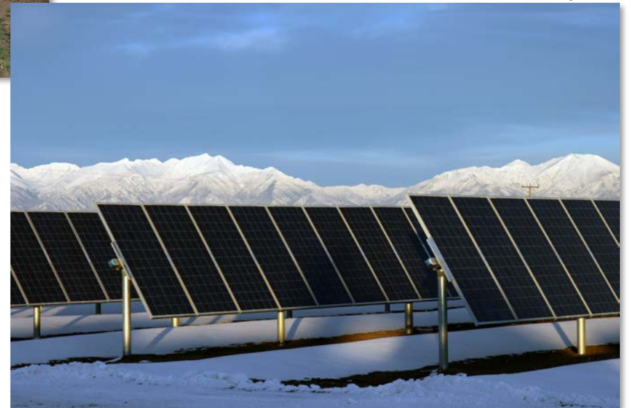
Système solaire photovoltaïque au sol (réseau fixe)
