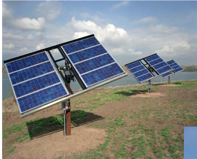
Système solaire photovoltaïque à suiveur à axe unique
