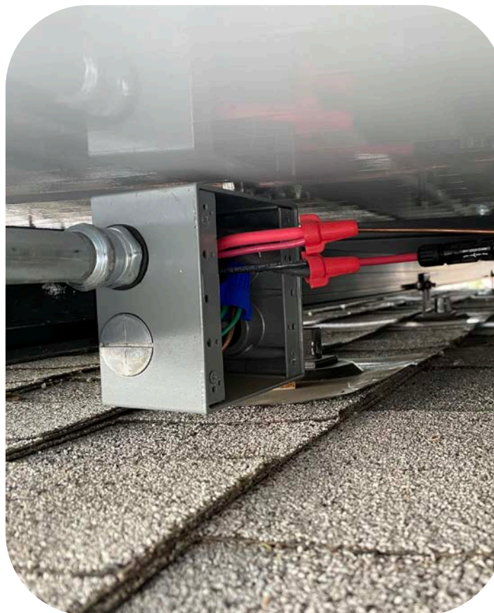
Transition entre le fil PV et le fil dans le conduit jusqu'à l'onduleur.
