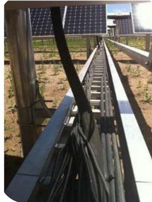
Chemins de câbles
